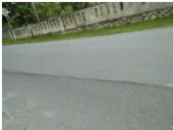
Gambar 4.3 Dokumentasi Kerusakan STA 0+000 s/d 0+050 (Alur)
