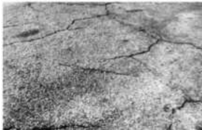
Gambar 2.10 Retak Kotak Kotak ( Block Cracking )
