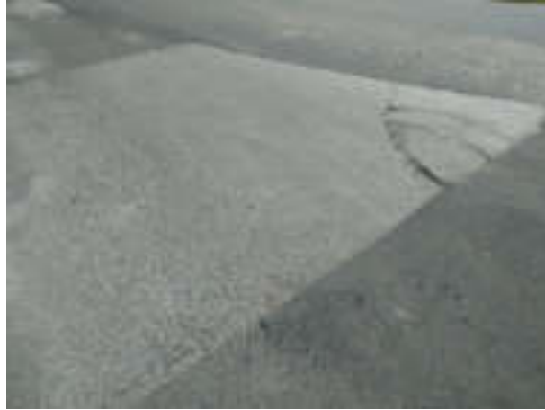
Gambar 4.1 Dokumentasi Kerusakan STA 0+000 s/d 0+050 (Tambalan)
