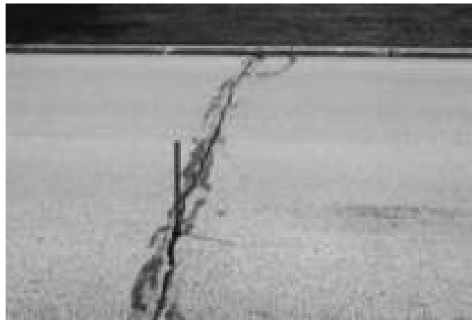
Gambar 2.24 Retak Memanjang / Melintang ( Longitudinal/Transverse Cracking )
