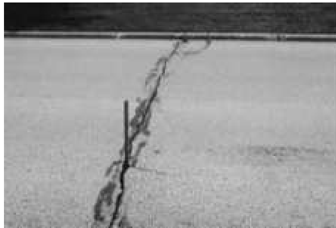
Gambar 2.24 Retak Memanjang / Melintang ( Longitudinal/Transverse Cracking )
