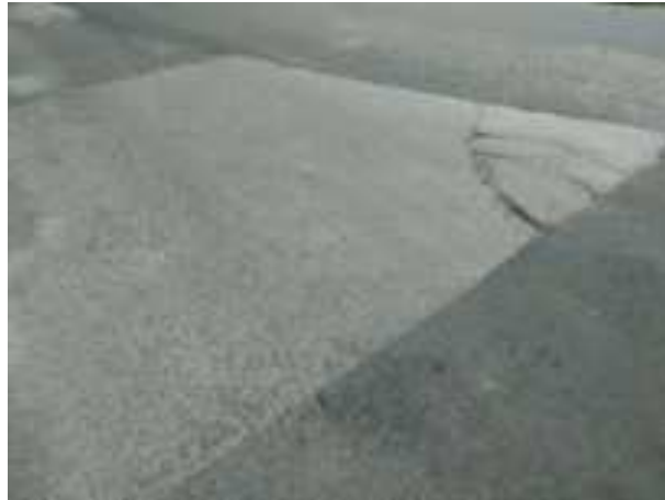
Gambar 4.1 Dokumentasi Kerusakan STA 0+000 s/d 0+050 (Tambalan)
