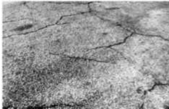
Gambar 2.10 Retak Kotak Kotak ( Block Cracking )
