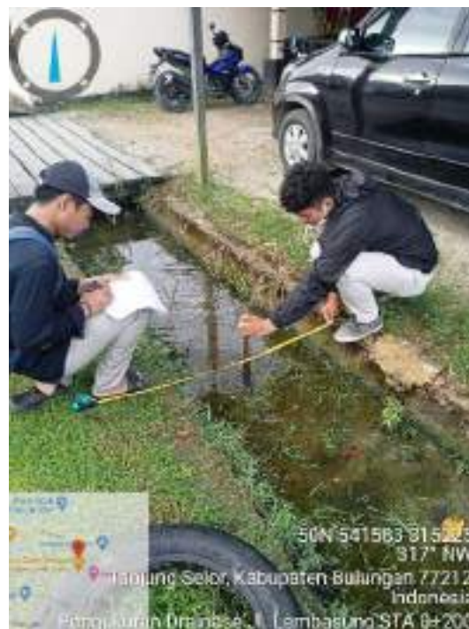
Gambar 4.3 Saluran Eksisting dengan Endapan Sedimen
