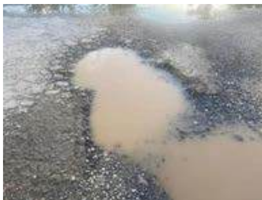
Gambar 4.13 Kerusakan di STA 0+600 – 0+650 (Pelepasan Butir)
