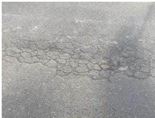
Gambar 4.11 Kerusakan di STA 0+500 – 0+550 (Retak Buaya)
