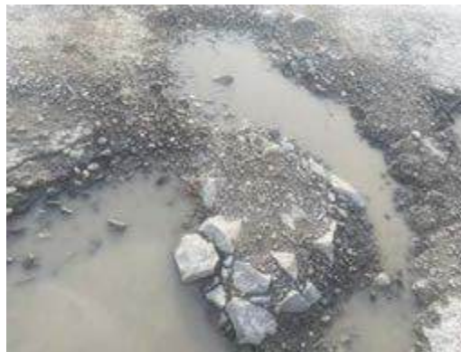
Gambar 4.1 Kerusakan di STA 0+000 – 0+050 (Pelepasan Butir dan Fatty)
