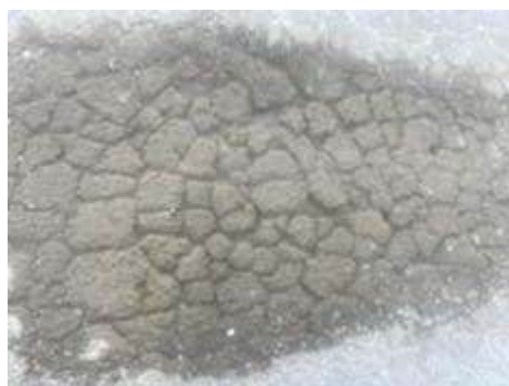
Gambar 4.3 Kerusakan di STA 0+100 – 0+150 (Retak Buaya)
