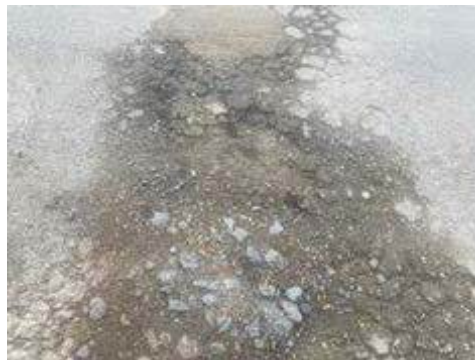
Gambar 4.2 Kerusakan di STA 0+050 – 0+100 (Pelepasan Butir)
