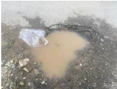
Gambar 4.5 Kerusakan di STA 0+200 – 0+250 (Pelepasan Butir)
