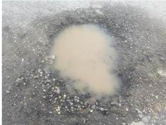
Gambar 4.7 Kerusakan di STA 0+300 – 0+350 (Pelepasan Butir dan Lubang)
