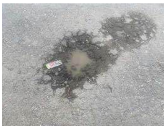
Gambar 4.4 Kerusakan di STA 0+150 – 0+200 (Pelepasan Butir)
