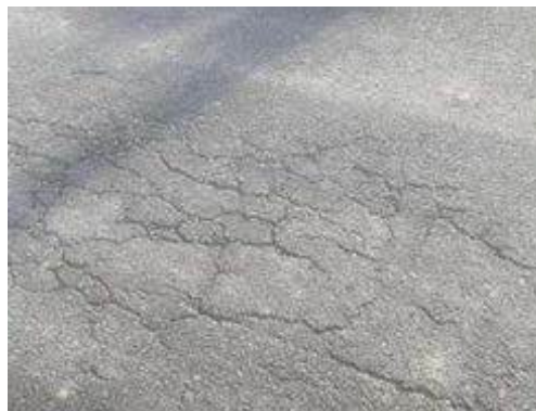
Gambar 4.8 Kerusakan di STA 0+350 – 0+400 (Retak Buaya)
