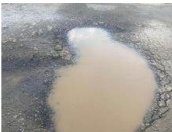
Gambar 4.14 Kerusakan di STA 0+650 – 0+695 (Pelepasan Butir)
