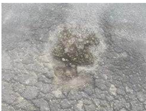
Gambar 4.9 Kerusakan di STA 0+400 – 0+450 (Pelepasan Butir dan Lubang)
