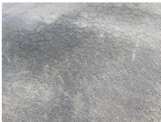
Gambar 4.10 Kerusakan di STA 0+450 – 0+500 (Retak Buaya)
