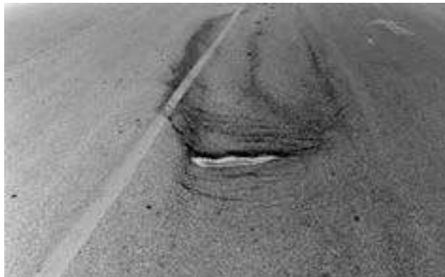
Gambar 2.6 Jenis Jenis Kerusakan Jalan
