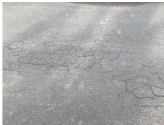
Gambar 4.12 Kerusakan di STA 0+550 – 0+600 (Retak Buaya)
