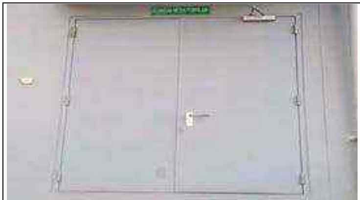
Ruang Mesin Pompa Air
