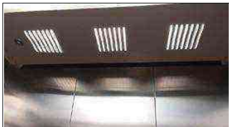
Saluran Udara Pengganti Dalam Lift
