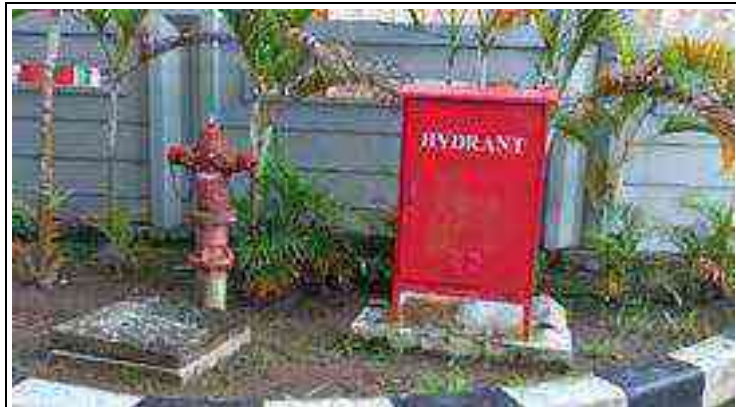
Hidran Halaman Berada Di Halaman Samping Gedung
