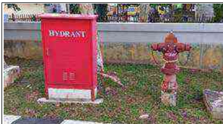
Hidran Halaman Berada Di Halaman Samping Gedung
