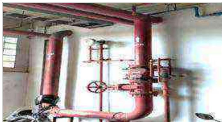
Sistem Pemadam Kebakaran
